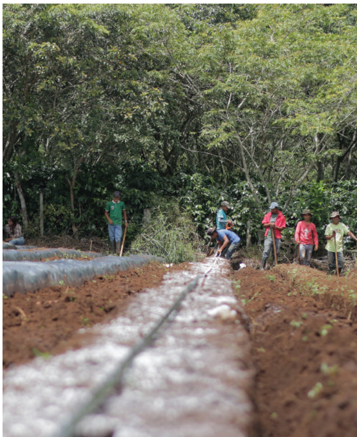
Fotografía: SAG-UPEG / Sistema de riego Calpules, Esquias, Comayagua
