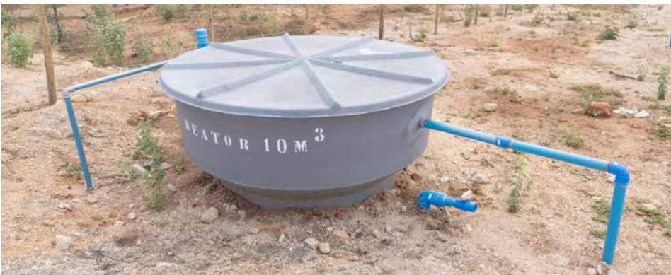
Imagem 14 – Reator UASB instalado
