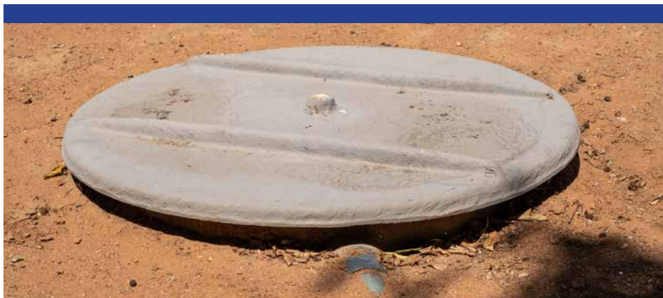
Imagem 06 – Reator UASB instalado
