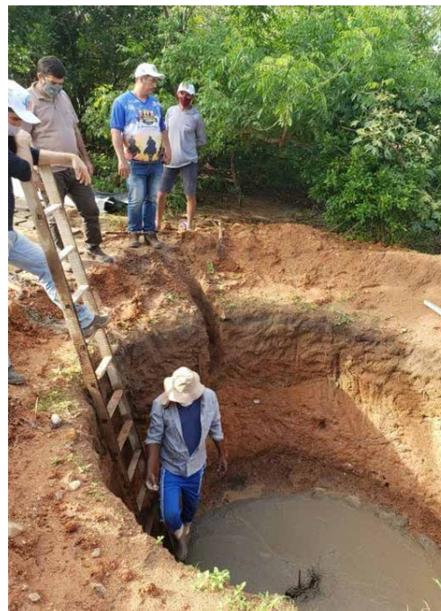
Marcação do centro, onde o cano guia será instalado. Foto: Acervo Pró Semiárido
