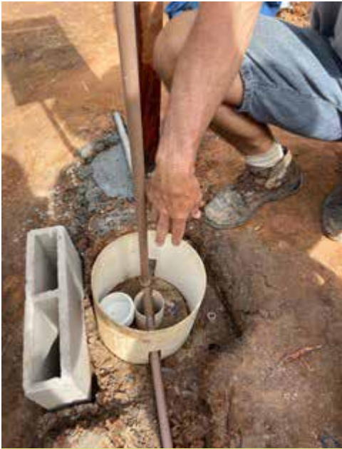
Dreno instalado no ponto mais baixo da tubulação de gás. Acervo: Pró Semiárido
